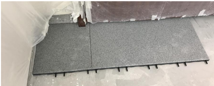
Verlegung der Platten entlang einer graden Wand mit den Steckverbindern nach vorne
